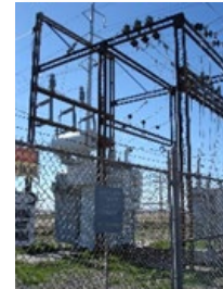
Casa Grande Substation
